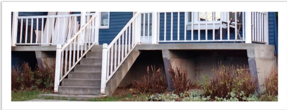
Figure 145: Plate-forme en béton qu'il faut absolument proscrire. Maison sise à Ville de Bécancour. Crédit photo: Patrimoine Bécancour.
