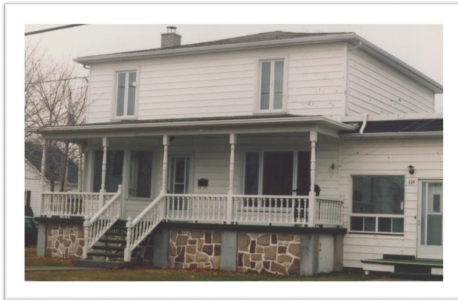
Figure 182: Le dessous d'une galerie n'est pas une remise que l'on ferme impunément, au besoin! Ailleurs, l'espace de rangement! L'imitation de pierre choisie, comblant l'espace entre deux panneaux de bois trop larges, représente un choix inapproprié, considérant les intéressantes colonnes, balustrades et rampes. Photo de Jean-Pierre Chartier.
