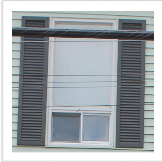
Figure 111: Volets de vinyle non justifiés, flanquant une fenêtre à base coulissante. La fenêtre coulissante est toujours à proscrire dans tous les cas. Pour que les volets prennent une apparence fonctionnelle, il faut qu'ils soient ici plus larges et posés plus près du cadre de la fenêtre. Maison sise à Ville de Bécancour. Crédit photo: Patrimoine Bécancour.
