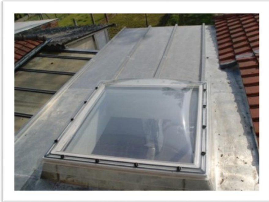
Figure 86: Tout puits de lumière est toujours à éviter en ce qui a trait à la maison ancienne. Image de source inconnue.
