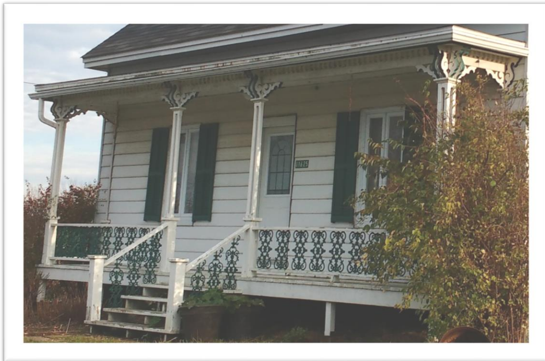
Figure 142: Balustrade munie de fer de galerie en fonte. Éléments traditionnels à conserver. Maison sise au 11 625, boul. Bécancour, à Sainte-Angèle. Crédit photo: Patrimoine Bécancour.
