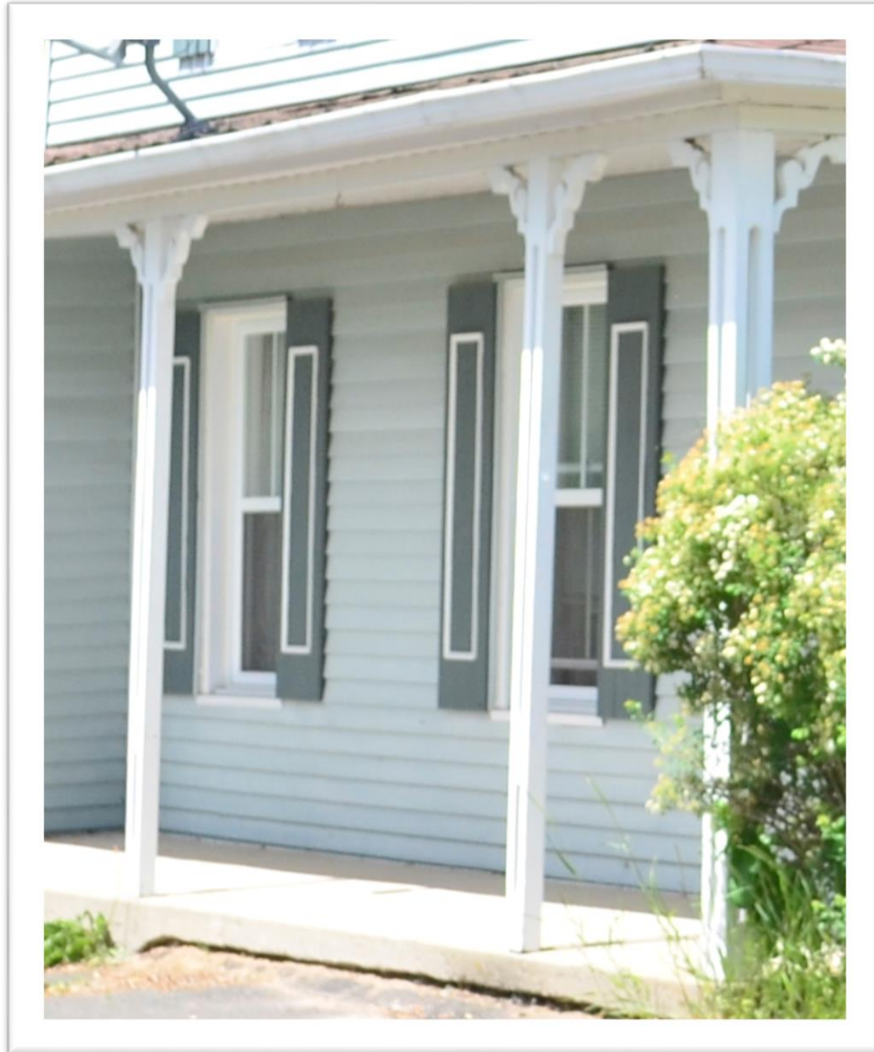
Figure 128: Remarquez la colonne du coin à droite composée de trois pièces de 2 pouces et ses colonnes intermédiaires munies cette fois de deux pièces. Ce type de colonne est souvent rencontré dans Ville de Bécancour. La base de la colonne est toutefois absente. Maison sise au 2350, Nicolas-Perrot, à Bécancour. Crédit photo: Patrimoine Bécancour.
