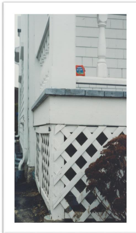
Figure 180: D'abord, le type de treillis aux espacements trop larges n'est pas du tout adéquat. Et ensuite, ce treillis ne doit jamais être fixé par-dessus les poteaux de soutien de la plate-forme de la galerie. Ce treillis mal posé « jure » avec la qualité du choix des colonnes et de la balustrade de la galerie. Photo de Jean-Pierre Chartier.
